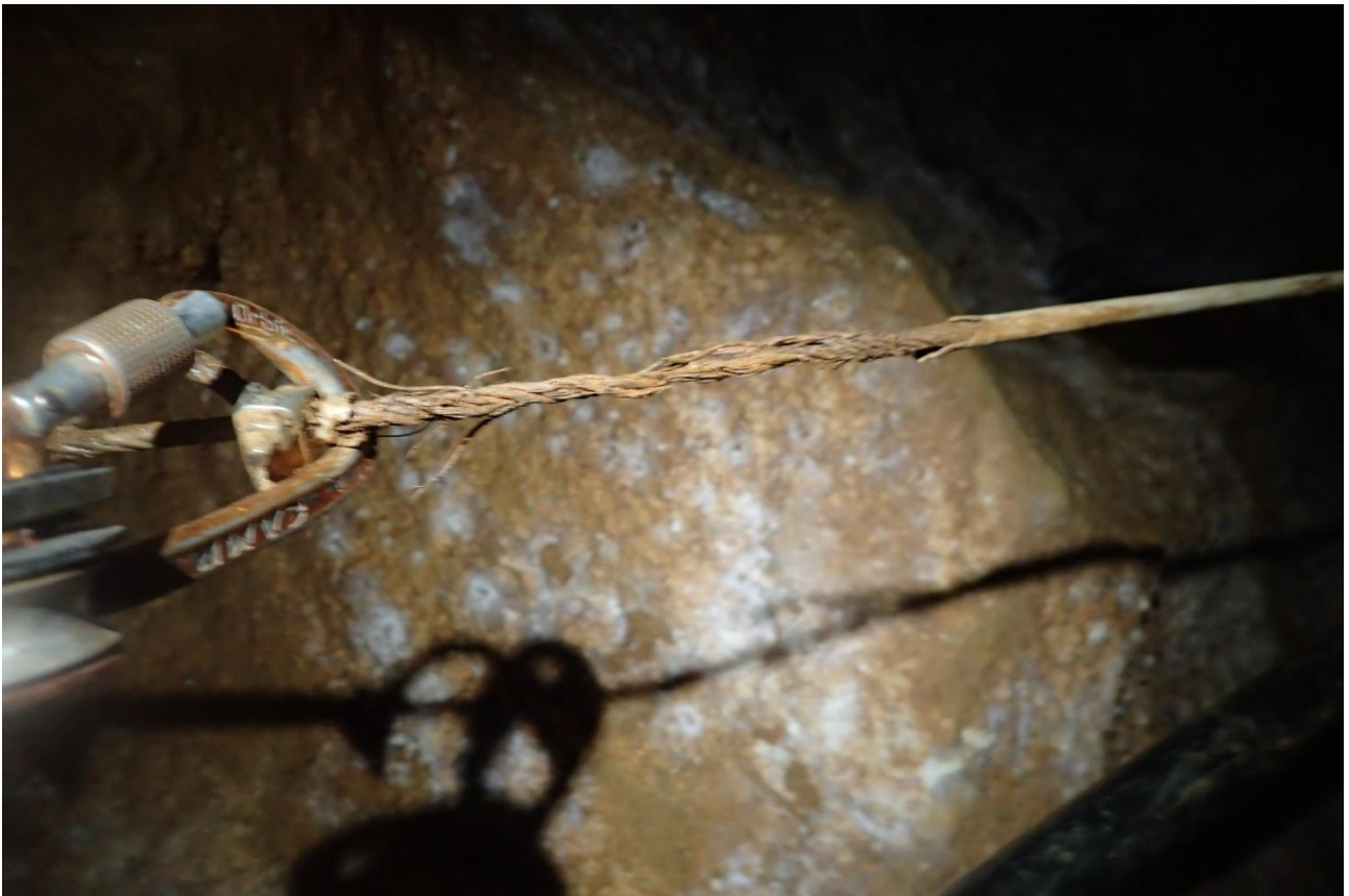
L'état du câble à l'aller... Depuis il a été retiré et temporairement changé par une corde
